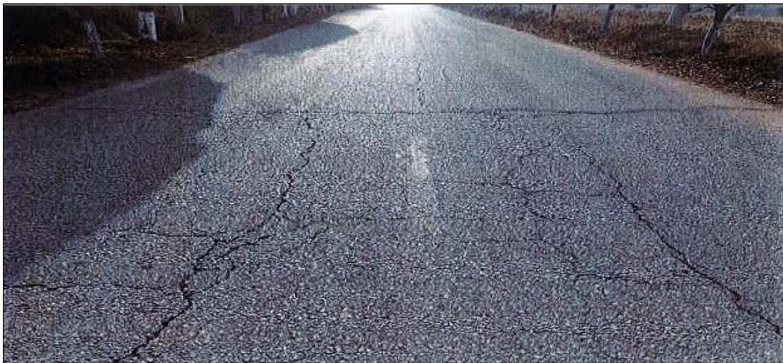
图1-1 沥青路面现况-纵横缝
