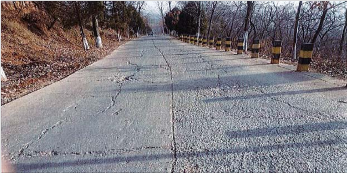
图 1-2 混凝土路面现况-破碎、裂缝
