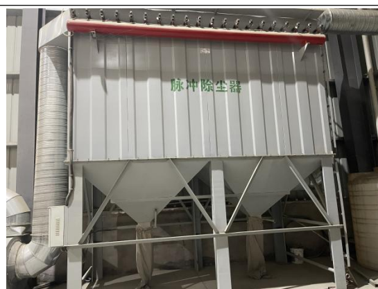
沥青混凝土生产线混合废气处理设施
