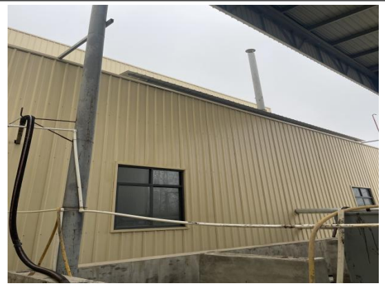
导热油炉排气筒
