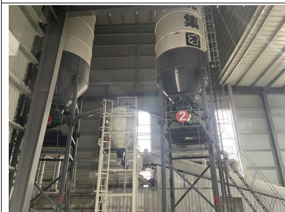
水泥稳定料生产线原料储罐
