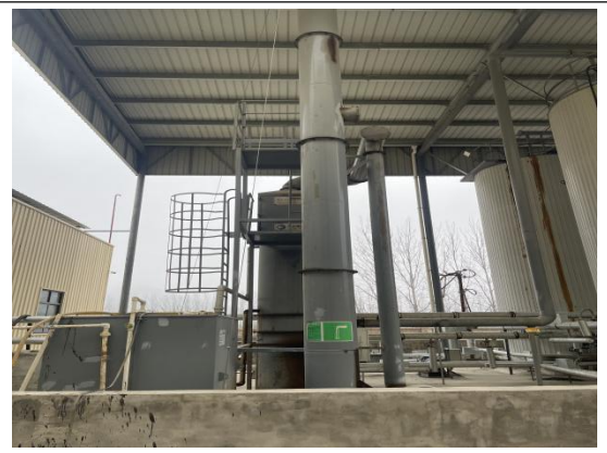
沥青储罐区废气处理设施及排气筒
