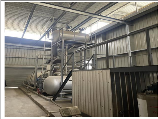
导热油炉废气处理设施
